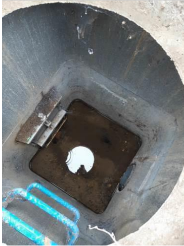
Exutoire du bassin de rétention et vanne manuelle de régulation du débit de fuite
